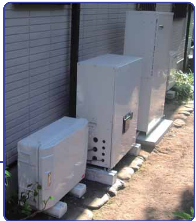
家庭用 SOFC コージェネレーションシステム (TOTO)
