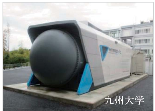
SOFC-MGT ハイブリッドシステム (2015年 年報) (提供: 三菱日立パワーシステムズ)
