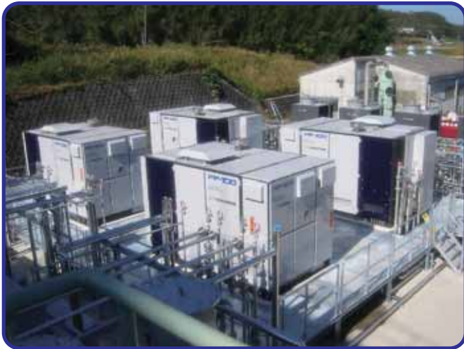
4台設置のPAFC（熊本北部浄化センター） （富士電機アドバンステクノロジー）
