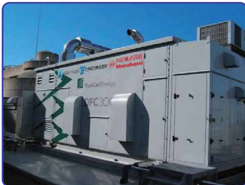
福岡市西部水処理センターで 稼働している DFC300 (丸紅)
